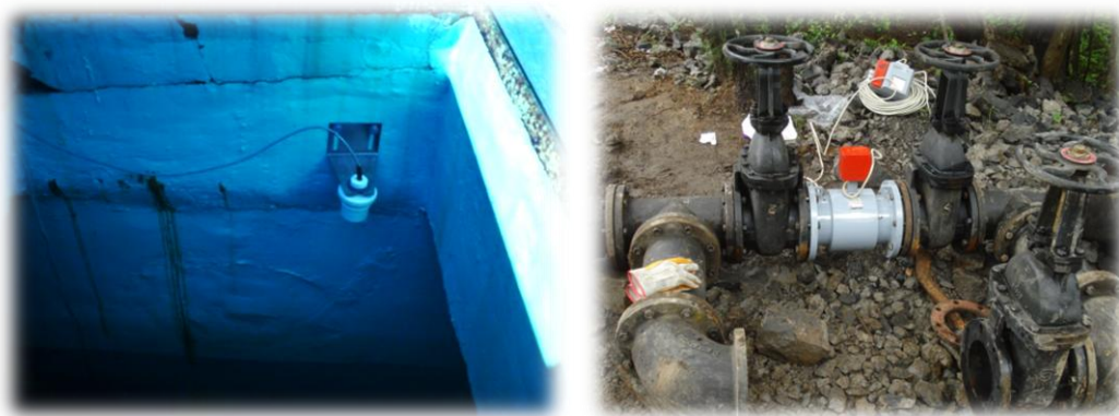
Figura 1. Medidores electromagnéticos (Derecha) y sensores de nivel instalados (Izquierda) durante 2010.
